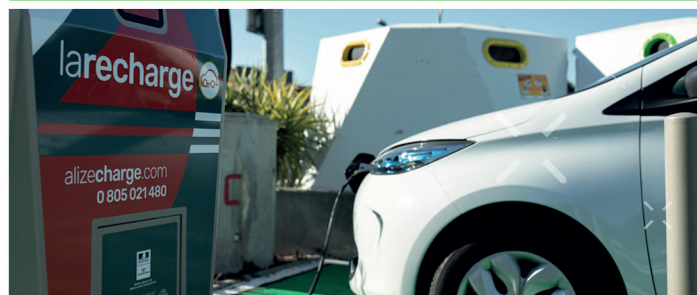
BORNE DE RECHARGE PUBLIQUE DE VÉHICULES ÉLECTRIQUES
