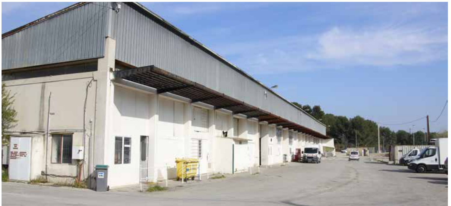
Ces hangars vétustes seront prochainement détruits.
